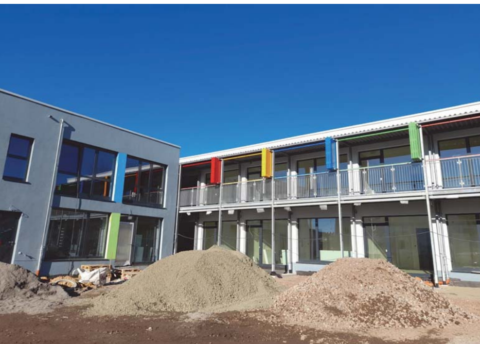
Wo jetzt noch Erdarbeiten vorbereitet werden, entsteht bald das Außengelände der neuen Kita St. Norbert.
